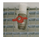
Purge bac de rétention
