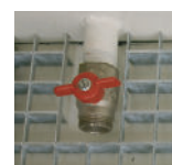
Purge bac de rétention
